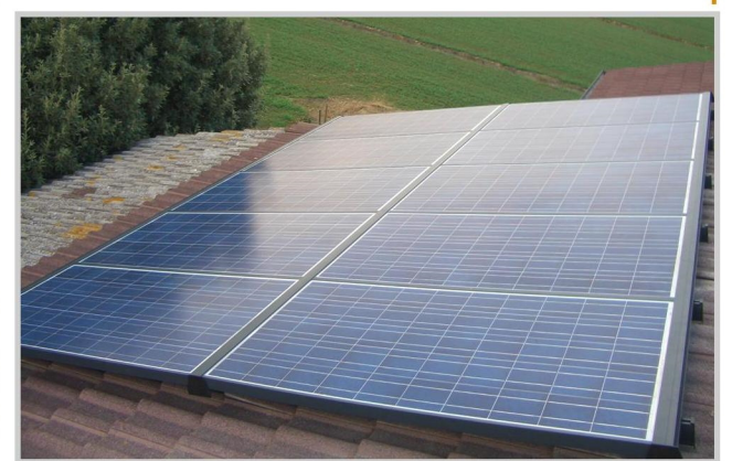
altri impianti fotovoltaici
